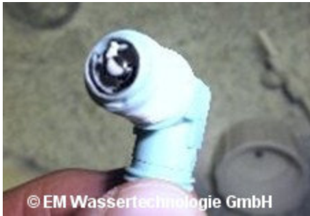
Bild rechts: Durch Kalk zerstörter Durchflussbegrenzer
