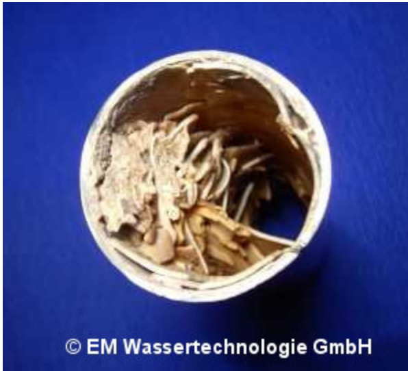
Bild rechts: Wasserrohr, das 20 Jahre lang in München verbaut war
